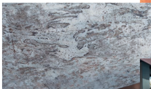
Overfladeændring grundet kondens på zinkplade.
