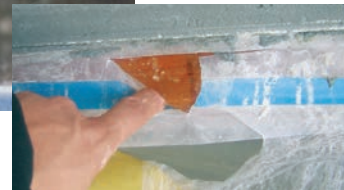
Beskadiget træ efter pudsning. Årsag: Afdækning med folie uden tilstrækkelig klæbekraft.
