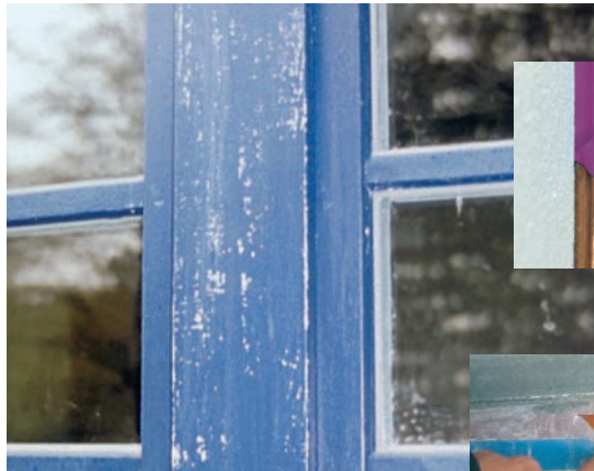
Revner grundet akrylmaling, som ikke er tilstrækkeligt tør.
