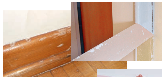
Skader på ældre lag lak/maling grundet for stor klæbekraft.
