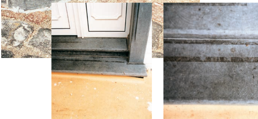
Farveændringer på natursten (belgisk granit, mat overflade) efter brug af selvklebende tape.
